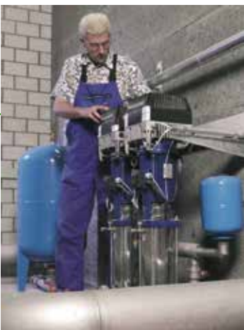
Pumpen und deren Steuerungen stehen oft im Fokus von Energiesparpotenzialen. (Bild: Häny AG)
