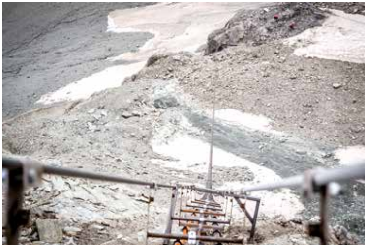
Der Blick nach unten entlang der Hängeleitung
