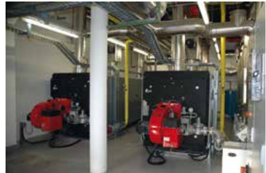
Die beiden neuen 2,15 MW-Kessel mit Weishaupt-Gas-Gebläseburnern
