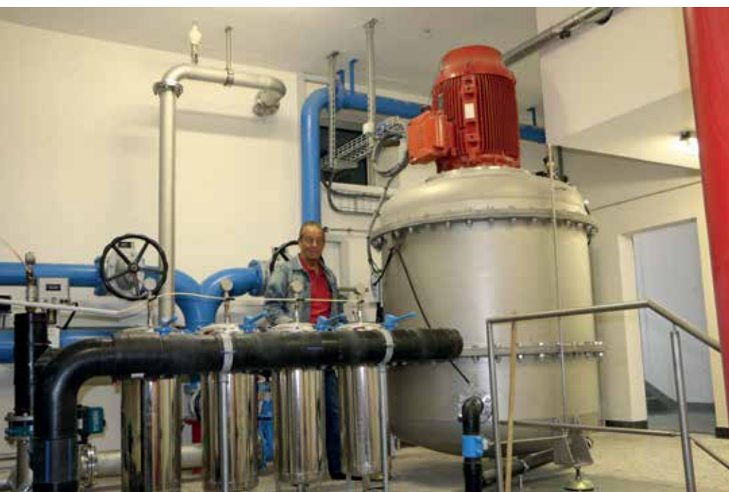
Komplette Anlage der Gegendruck-Pelton-turbine Erlenbach mit Turbine, Filter- und UV-Anlage (Foto: Ryser Ingenieure AG)
