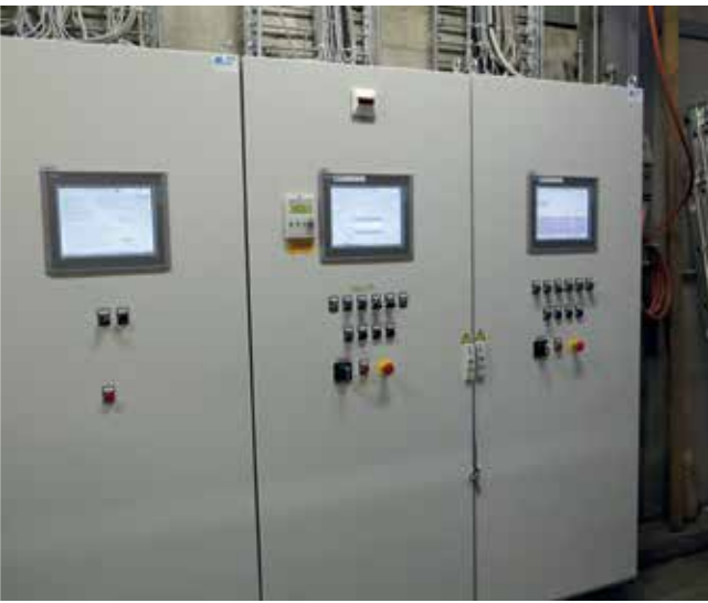
Der neue Schaltschrank in der Heizzentrale
