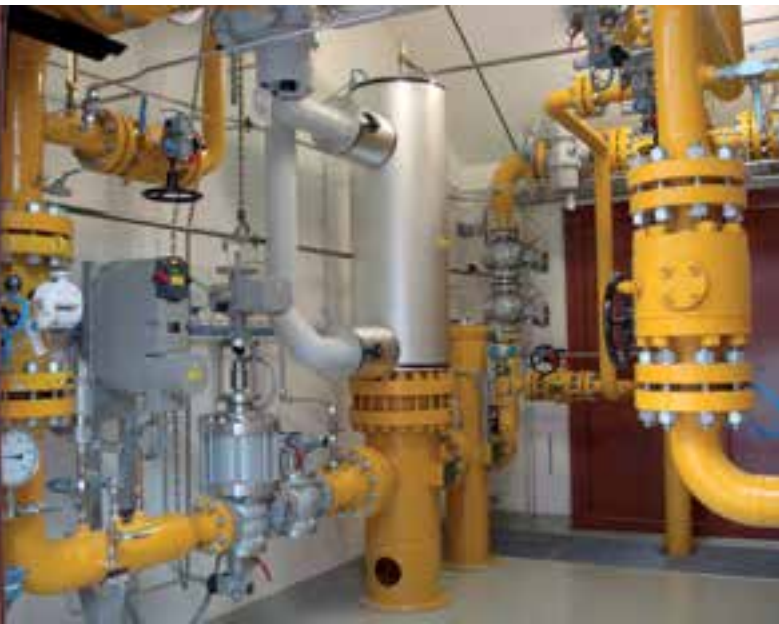
Die Druckreduzier-Anlage mit dem Vorwärmer zur Erdgas-Heizung
