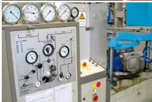
Prüfstände VAG Bancs d'essai VAG
